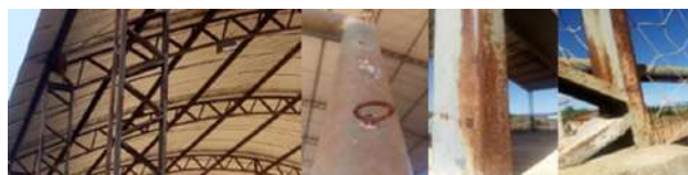
Figura 4: Corrosão por placas
