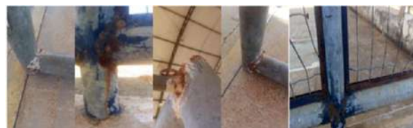
Figura 3: Corrosão em torno de solda
