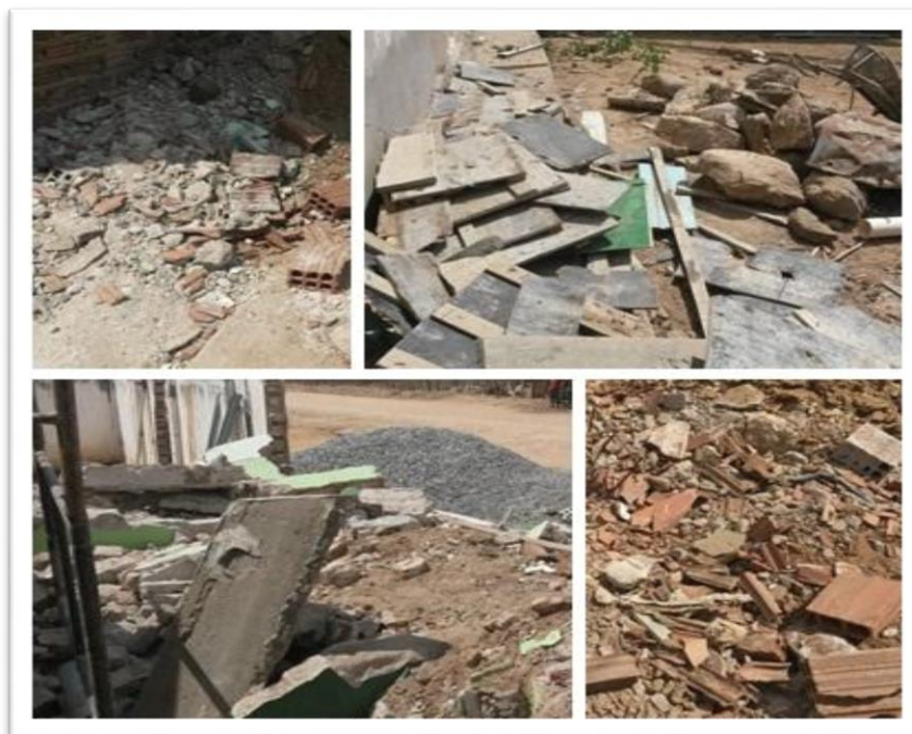
Figura 5: Alguns tipos de resíduos encontrados nas obras visitadas
