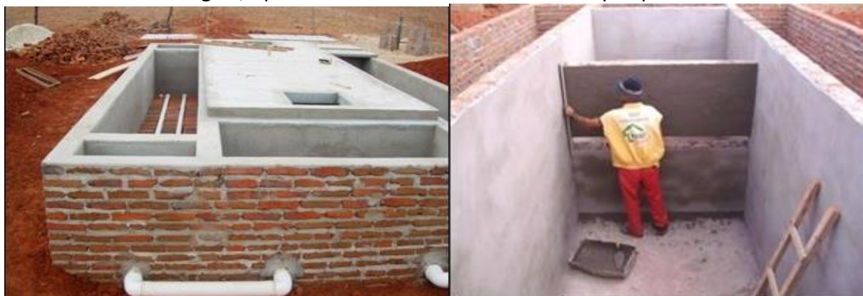
Figura 2. Sistema modular de tratamento de esgoto doméstico construído no Assentamento Milagres, Apodi-RN. Fonte: Dados do acervo de pesquisa.
